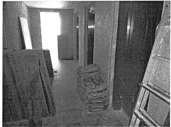
Frente elevadores subtelhado Bloco D
