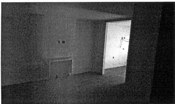
Apartamento subtelhado Bloco D
