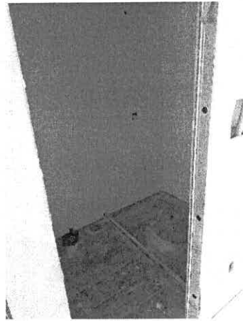
Banheiro subtelhado Bloco D
